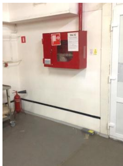
Obs_LimitedAccessFire Extinguishers (2).jpg
